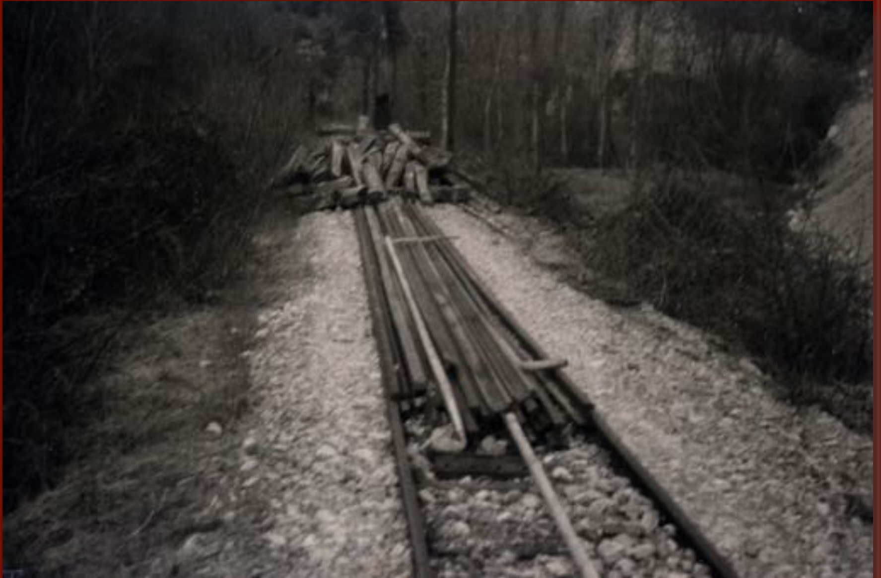
Smantellamento di rotaie e traverse lungo la tratta tra Nortosce e Serravalle. Foto anni '72 del '900. Spoleto, Collezione L. Fasciglione
