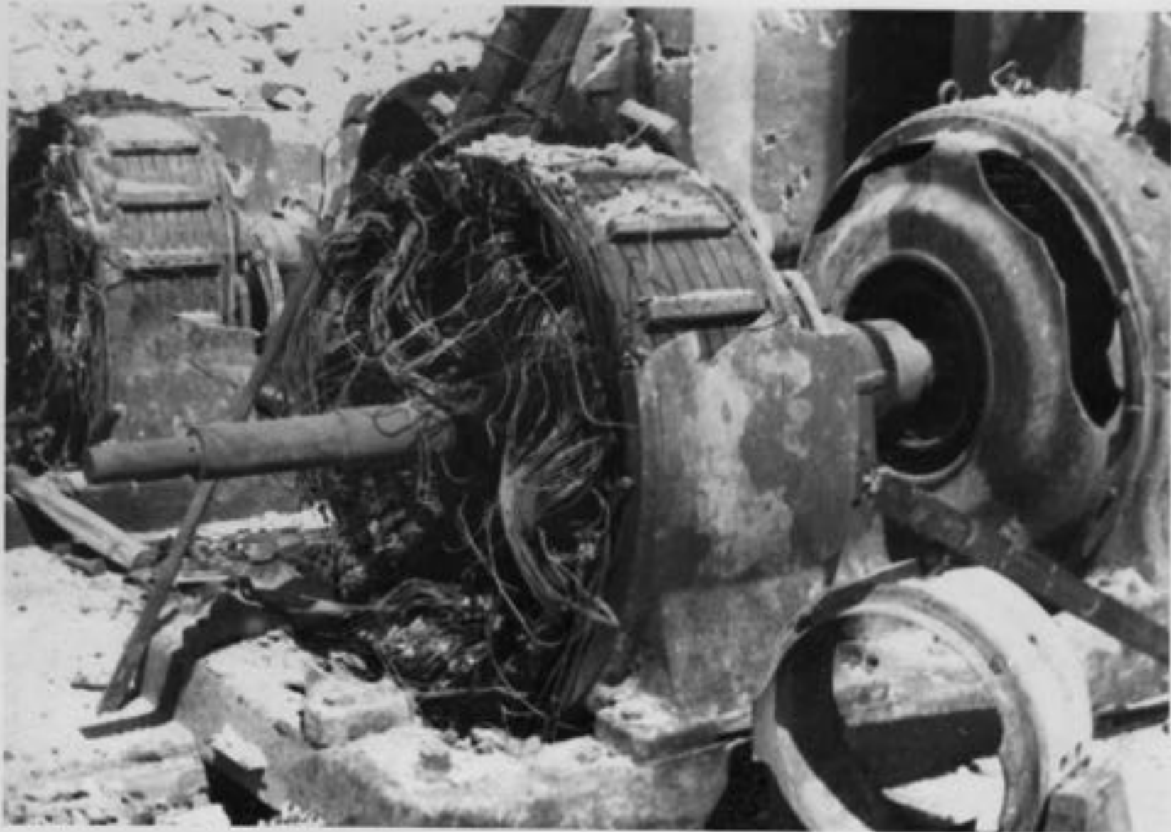
Sottostazione di Piedipaterno, gruppo convertitori minato, 1944. Spoleto, Sez. AS, Archivio P. Basler
